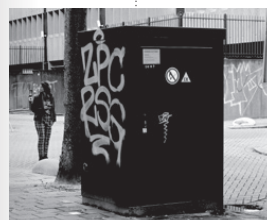
Transformator gebouwen worden kleiner door compact geïsoleerde leidingen
