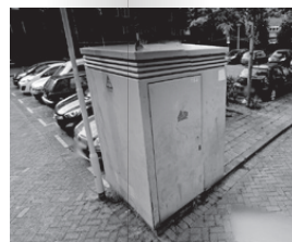
Standaard uitvoering compactstation Rotterdam Transformator uit betonnenvloer en aluminium wanden Provinciaal niveau
