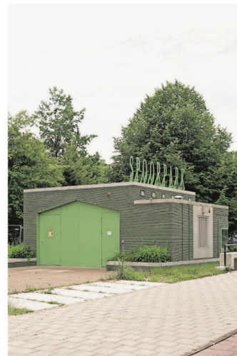
Natuurinclusief water-en-electriciteitshuisje, Postjesweg, Amsterdam.
