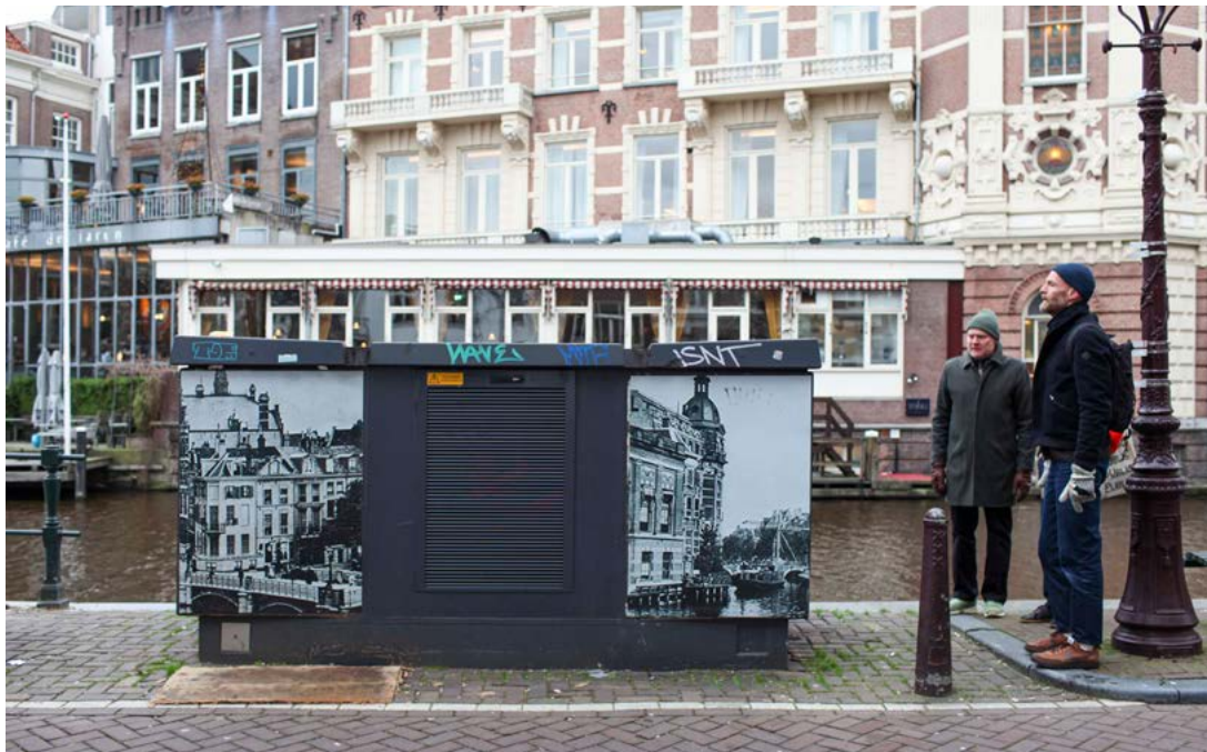
Transformatorhuisje. Foto: Lena de Rouw
